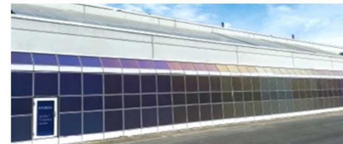
건물일체형 태양광 발전 시스템(음성공장)
